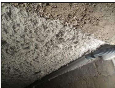
Photo N° 1039 ECH-N°1 FLOCAGE --COULOIRS DE CAVES Plafonds Flocage
