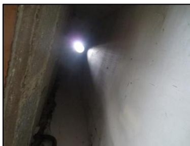
Photo N° 1048 AMIANTE CIMENT - -PLACARDS TECHNIQUES +4 Plafonds Ventilation haute (Fibres- ciment)
